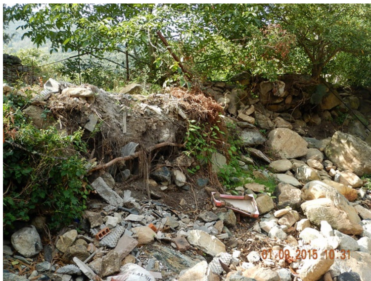
Dégradation de berge, accentuée par dépôt de déchets,
