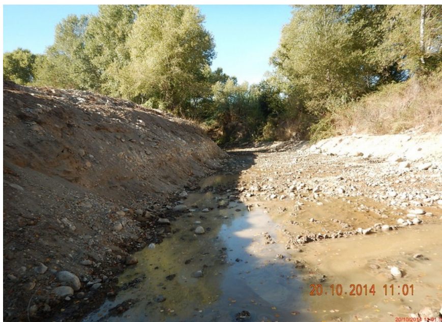
Domage créés en lit mineur par recalibrage avec extraction importante de matériaux
